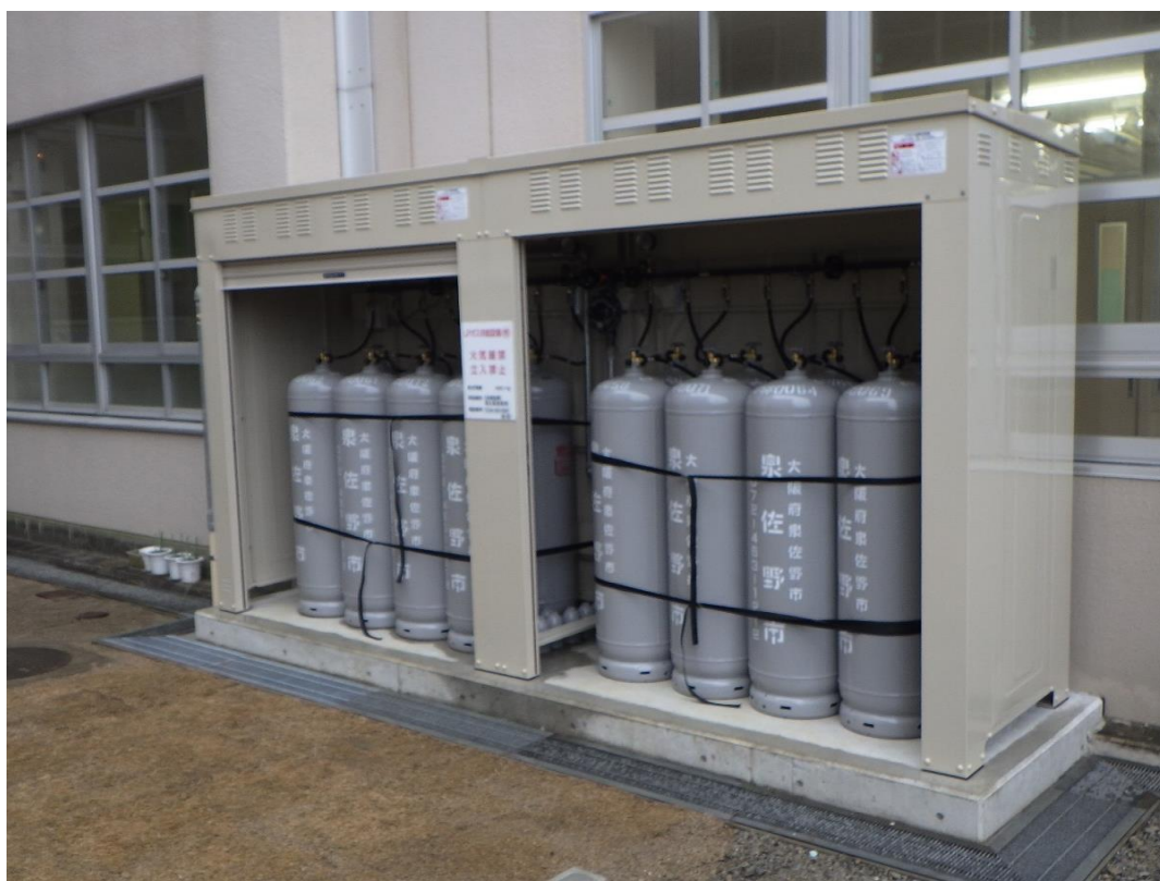
液化石油ガス 容器貯蔵
