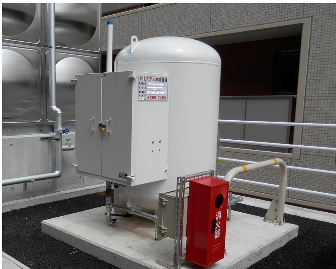
液化石油ガス バルク貯槽
