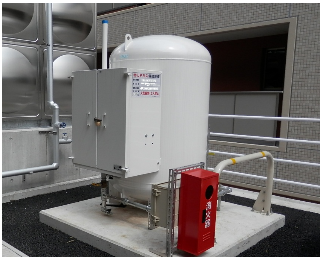
液化石油ガス バルク貯槽
