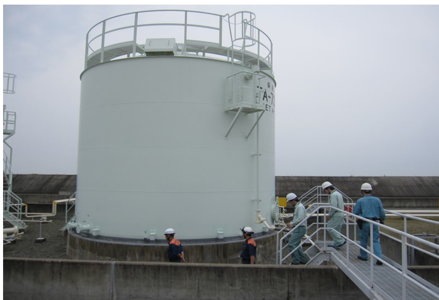
関西国際空港給油センター 屋外タンク貯蔵所の立入検査
