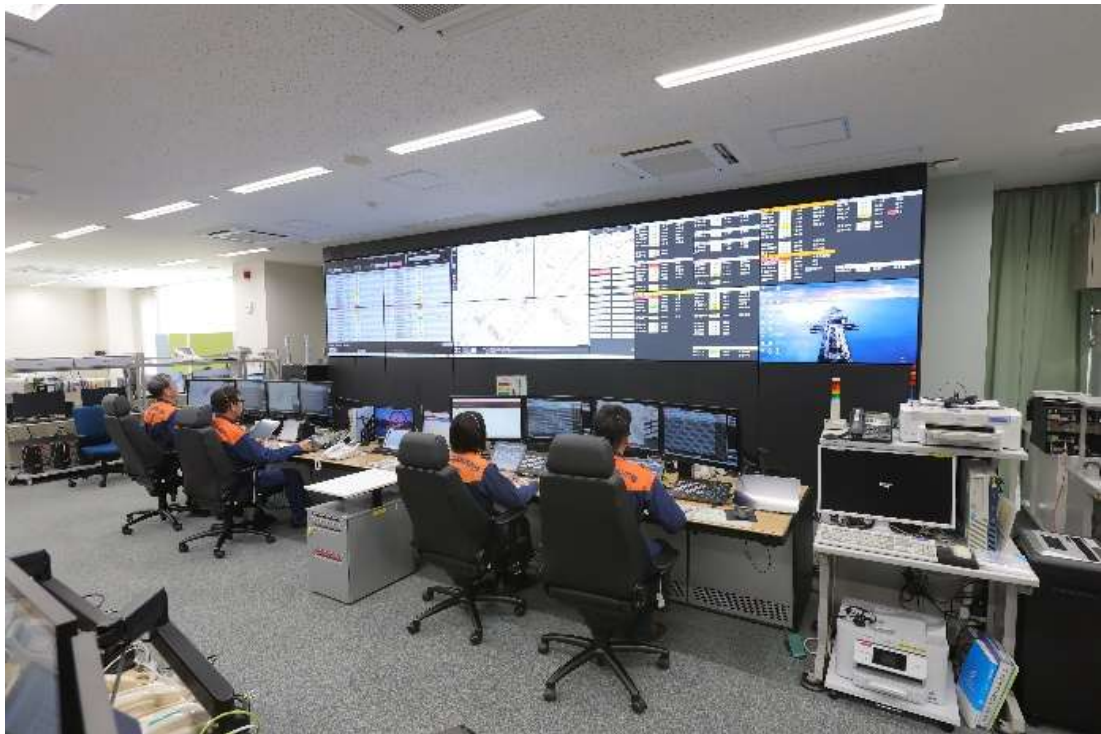
消防指令センター
